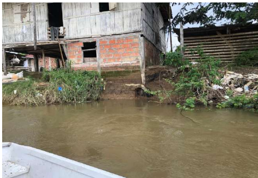
Gráfico 3: Socavón en el recinto La Piedad
