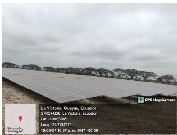
Gráfico 53: Planta de paneles solares
